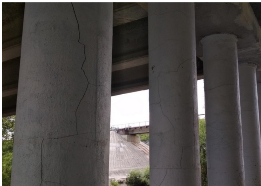
Рис. 1 Трещины на опорах моста
