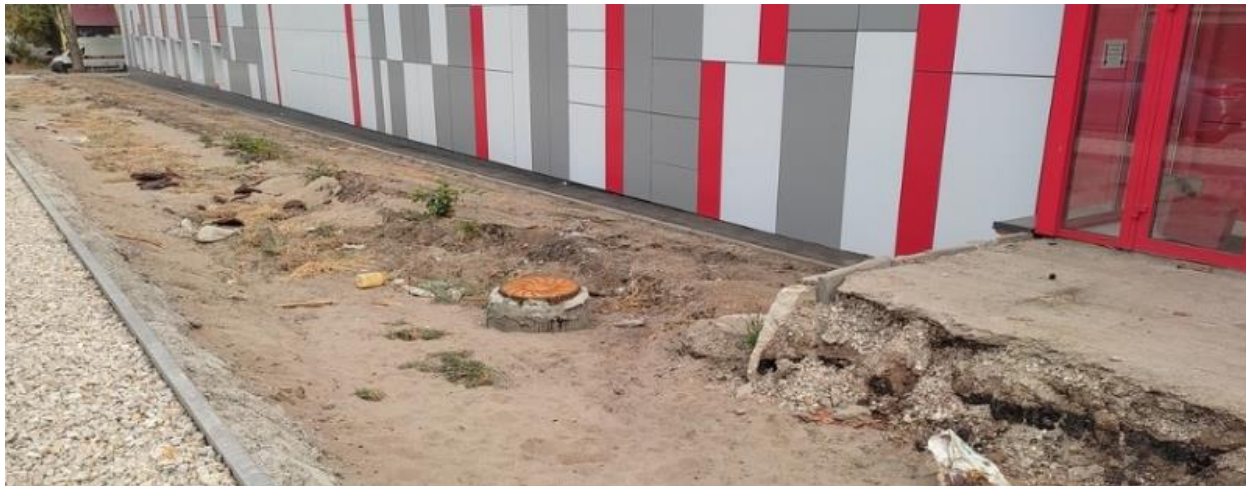
Рисунок 3 – Отсутствие восстановления тротуара и элементов благоустройства после завершения ремонта теплотрассы
